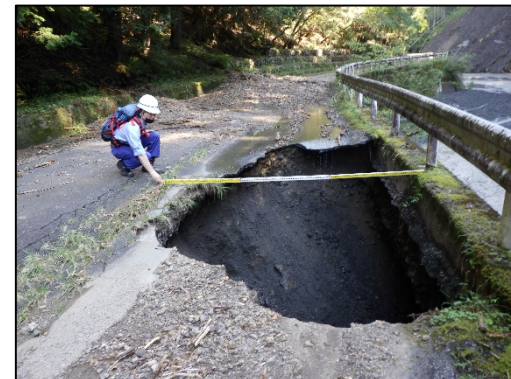
林道の陥没状況を調査
