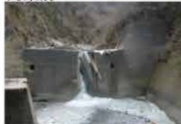
常時流水の影響による摩耗の進行
