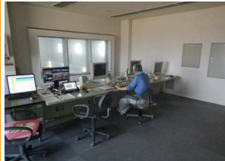
岐阜市 排水機場の操作
