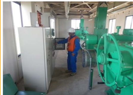
岐阜県 排水樋門の操作
