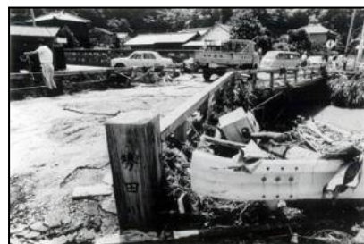
昭和49年7月洪水＋集中豪雨 溢水状況姫之橋 (勢田川5.7k付近)
