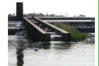
鈴鹿川第一頭首工に設置された魚道
