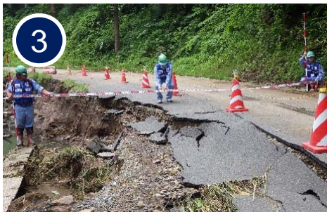
市道南外12号線の被害状況調査 (7月25日)
