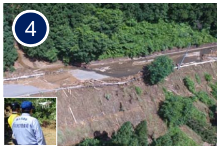
ドローンによる被害状況調査 (7月26日)
