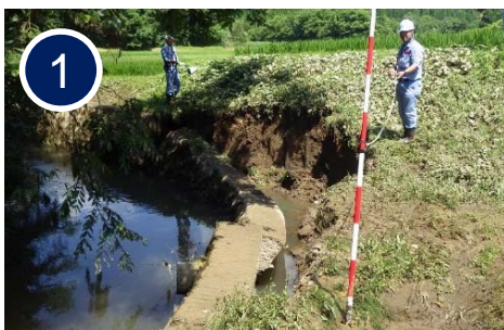
河川護岸の被害状況調査 (7月26日)
