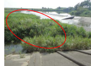
砂州の形成 (新屋敷取水堰下流)
