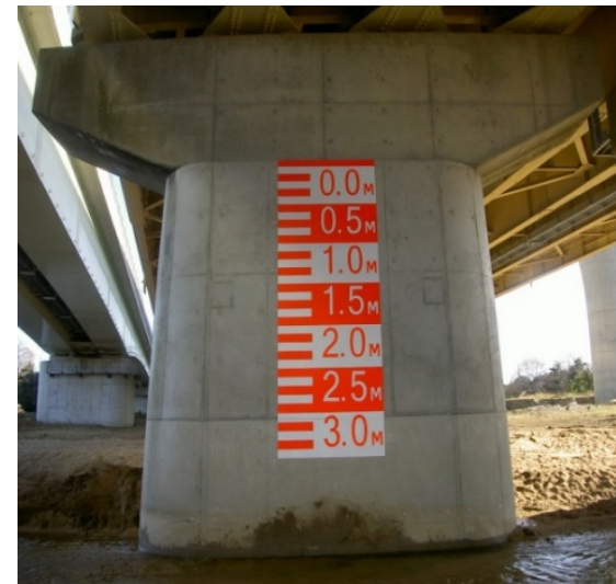
わかりやすい防災情報の表示 (河川水位：鈴鹿川橋)
