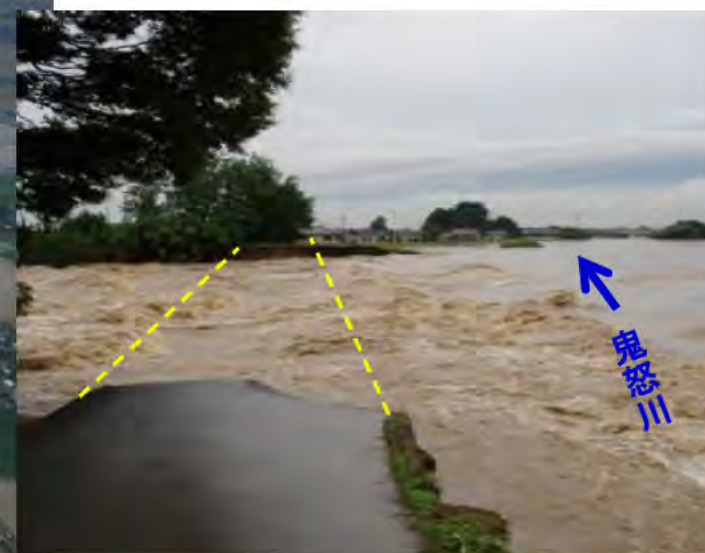
被災状況(拡大写真)
