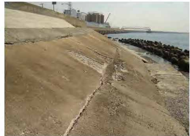
老朽化した高潮堤防 (鈴鹿川左岸1.0km付近)
