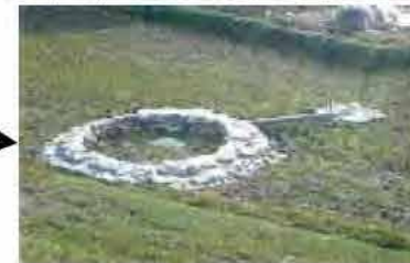
基盤漏水 (雲出川の事例)
