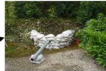
堤体漏水 (宮川の事例)
