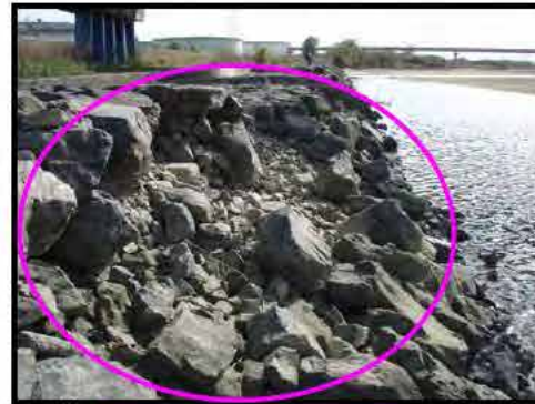
石積みが崩落
