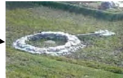
基盤漏水 (雲出川の事例)
