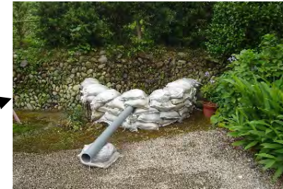
堤体漏水 (宮川の事例)
