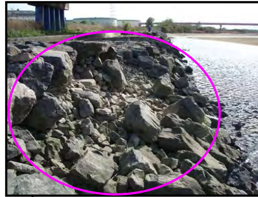
石積みが崩落
