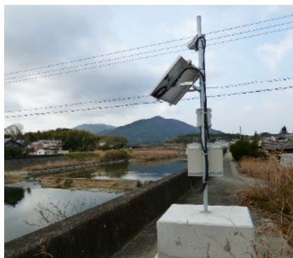
簡易型河川監視カメラ （三重県）
