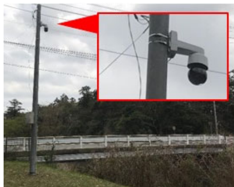
危機管理型水位計 （菰野町）
