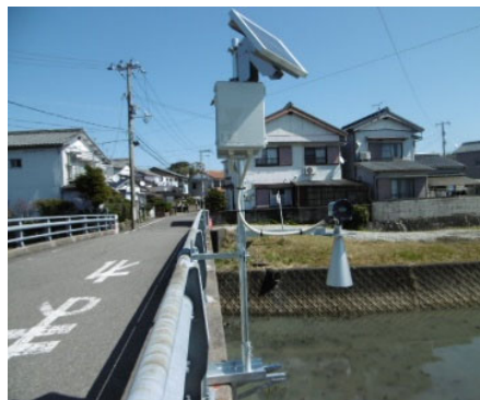
危機管理型水位計 （三重県）
