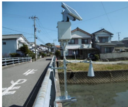
危機管理型水位計 （三重県）
