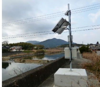
簡易型河川監視カメラ （三重県）
