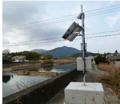
簡易型河川監視カメラ （三重県）
