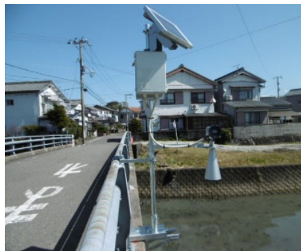
危機管理型水位計 (三重県)
