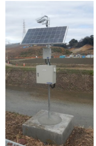
簡易型河川監視カメラ
