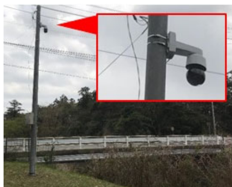
危機管理型水位計 （菰野町）
