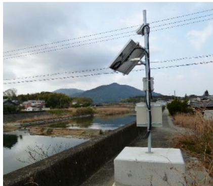
簡易型河川監視カメラ （三重県）
