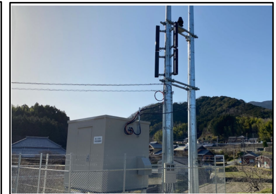
警報局設置状況
