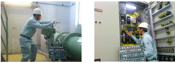
ポンプ場設備点検状況
