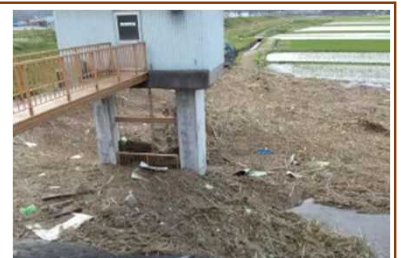
河川管理施設周辺の堆積事例
