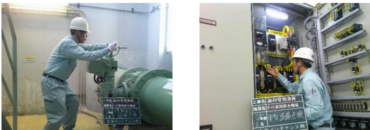
ポンプ場設備点検状況
