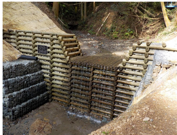
イメージ: 治山ダム整備箇所(他流域内)
