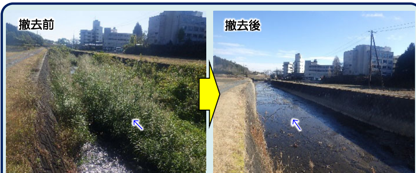
一級河川鎌谷川（四日市市山田町地内）
