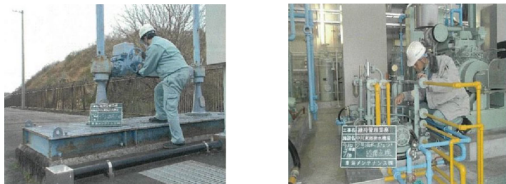
ポンプ場設備点検状況
