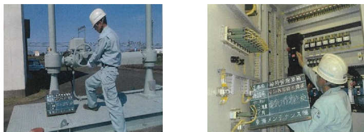
ポンプ場設備点検状況
