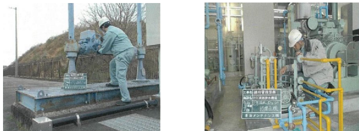
ポンプ場設備点検状況
