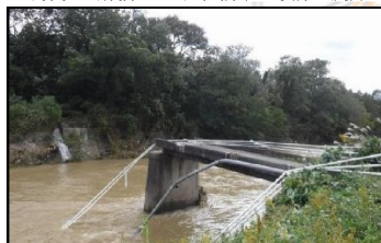
平成29年台風21号時被災状況 (増水で落橋した無名橋(大野橋上流))
