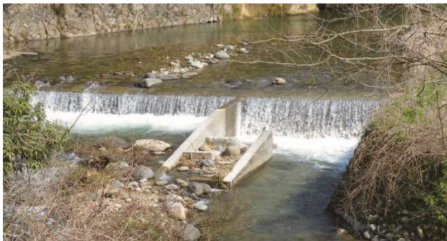
①過去に設置された魚道が破損
