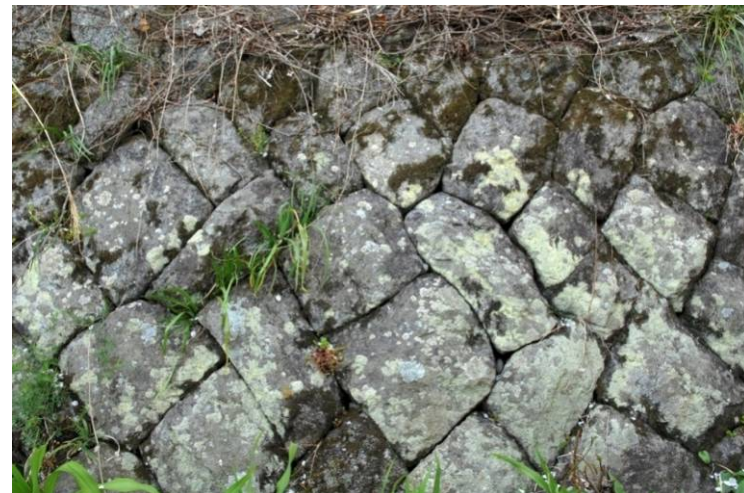
度会橋上流堤防裏に設置されている自然石護岸（空石積み）
