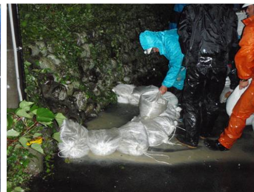
漏水の発生状況 H16年9月出水 右岸7.2km付近
