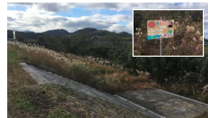
整備された階段護岸(榊田川13k付近) 前面に植物が繁茂し水辺に近づけない
