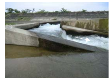
魚道折返部では、隔壁間の落差が60cm以上と大きく、流速も2m/sを越えている。
