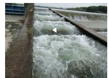
下流延伸区間では、頭首工(水叩き)からの越水が魚道内に流入し、流速が速くなっている。
