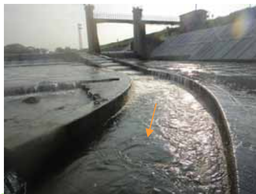
櫛田川第一頭首工 魚道 形式：階段式 魚道幅：2.8m 勾配：1/19
