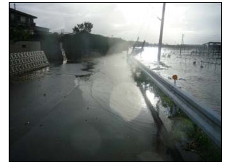
② H21 台風18号出水状況 (赤川地区)
