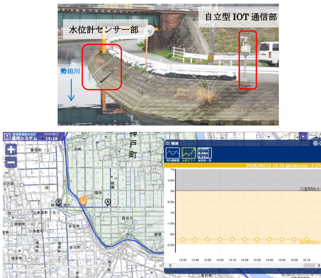
図 2-11 危機管理型水位計（勢田川左岸 4.6k 付近）と運用システムの表示イメージ
