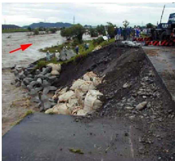
堤防の一部損傷
