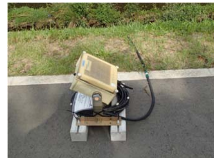
堤防に設置するタイプ （ケーブル（計測器）を河川に入れて計測）
