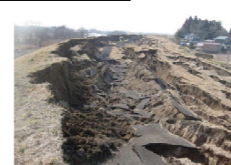
河川堤防の損傷
