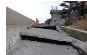
護岸・水叩きの損傷
