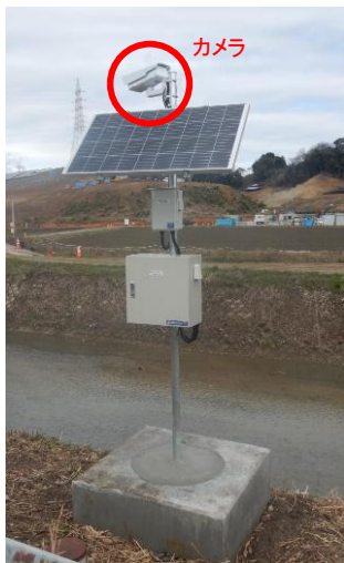
簡易型河川監視カメラ
