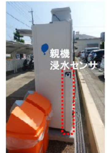
<自動販売機側 浸水センサ 1段>
