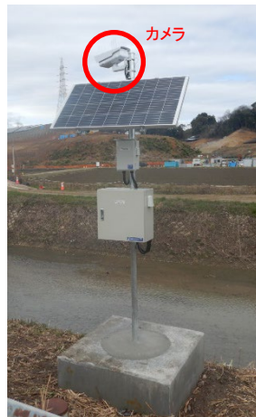
簡易型河川監視カメラ
