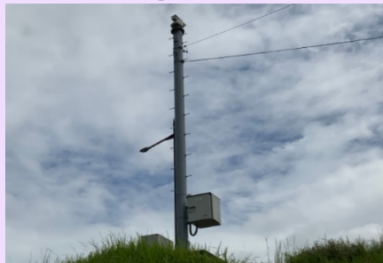
新両郡橋CCTV
