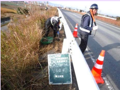
排水施設関係の清掃
