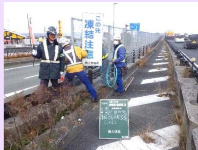
凍結注意看板の設置
