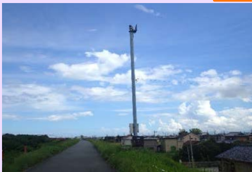
雲出橋観測所CCTV
