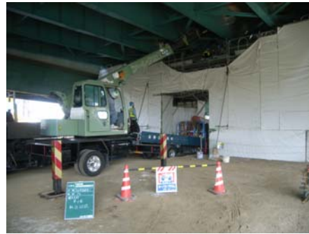
橋の脱落を防ぐ装置の設置状況
