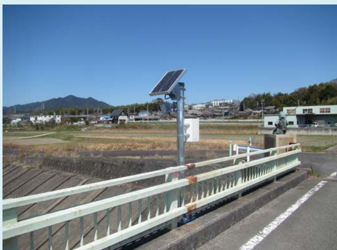
カメラ設置状況 (鈴鹿川左岸24.6km-78.6m (山下橋))
