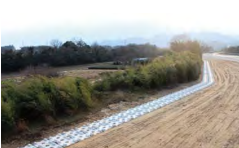
① 平成 26 年度 鈴鹿川地区木下根固設置工事 (右岸 25.6k 付近、亀山市木下町)
