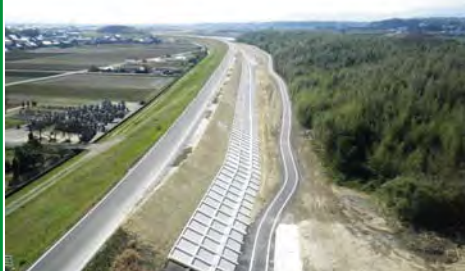
④ 平成 26 年度 鈴鹿川甲斐築堤護岸工事 (右岸 10.0k 付近、鈴鹿市甲斐町)
