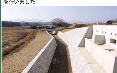
② 平成 25 年度 鈴鹿川鹿島橋左岸下部工事 (左岸 21.1k 付近、亀山市南鹿島町)
