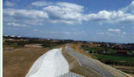
⑥ 平成 26 年度 鈴鹿川派川南五味塚築堤護岸工事 (右岸 3.6k 付近、四日市市楠町南川)
