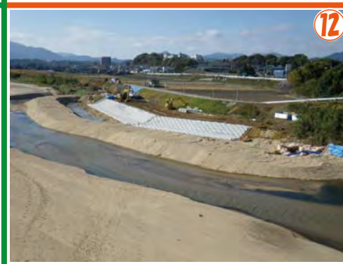
⑫ ①平成26年度 鈴鹿川維持工事 ②西口建工(株) ③H26.6.17 ~ H27.3.13 ④鈴鹿川全域にわたり、応急対策、部分的な護岸改修等のメンテナンス工事を行っています。
