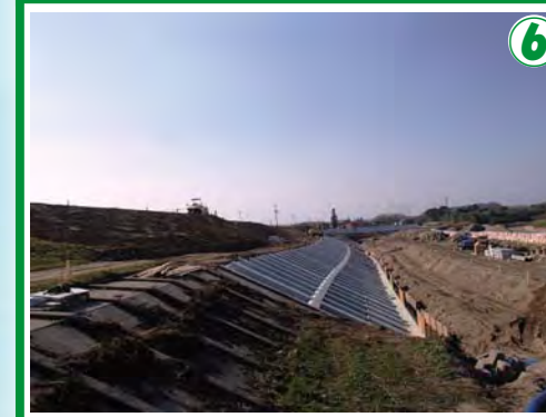
⑥ ①平成26年度 鈴鹿川派川南五味塚築堤護岸工事 ②信藤建設(株) ③H26.9.11 ~ H27.3.13 ④堤防を強くするため、堤防の幅を広くしコンクリートで保護する工事を行っています。
