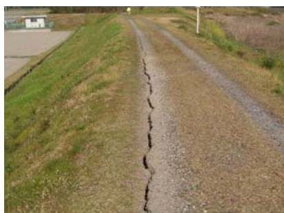
井尻地区での堤防が約30m亀裂
