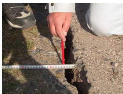
約5cm程度の割れ
