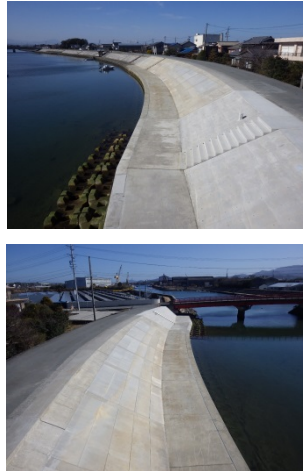
平成27年度 大湊川大湊地区堤防耐震補強工事 (株)山野建設
