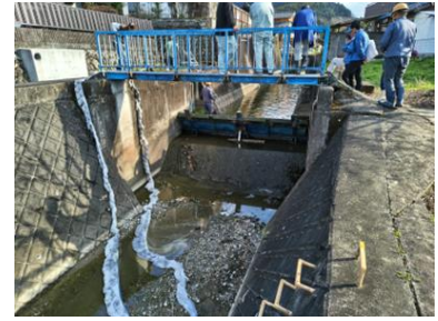
下流への油流出拡大防止のためオイルキャッチャーを設置
