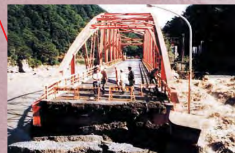
●昭和57年 三峰川橋の決壊状況
