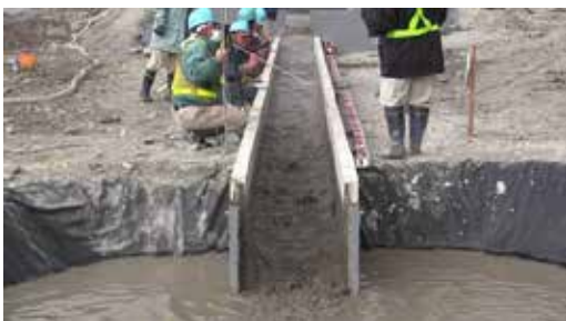
落下流の攪乱による土砂洗掘①
