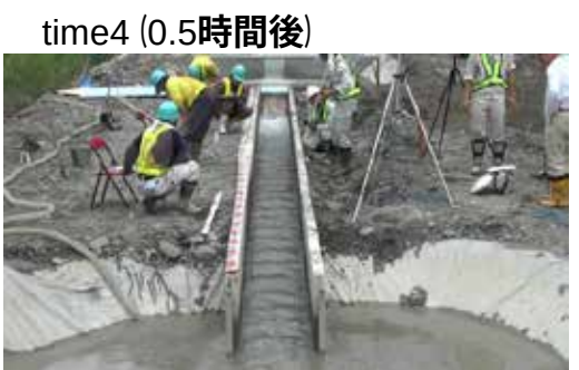
流水力による河床洗掘が進行②
