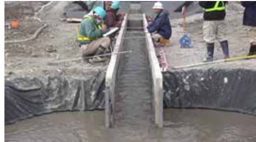
流水力による河床洗掘が進行
