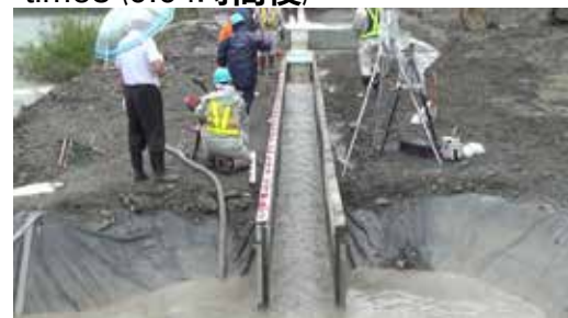
落下流の攪乱による土砂洗掘③
