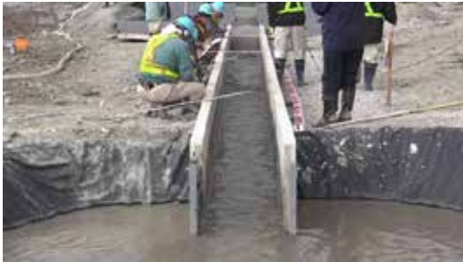
流水力による河床洗掘が進行(終了時)
