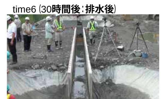
流水力による河床洗掘が進行 (通水終了)
