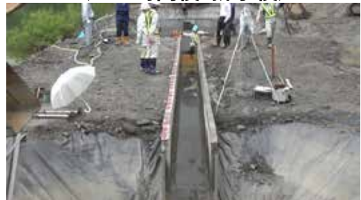
流水力による河床洗掘が進行(通水終了)
