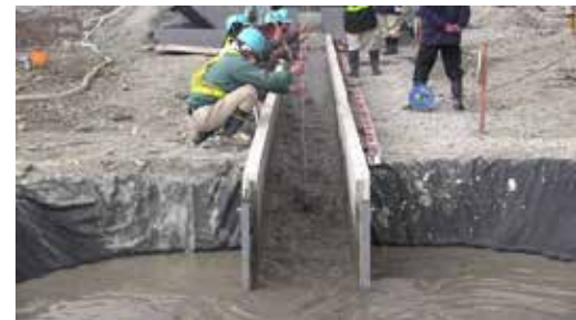
落下流の攪乱による土砂洗掘②
