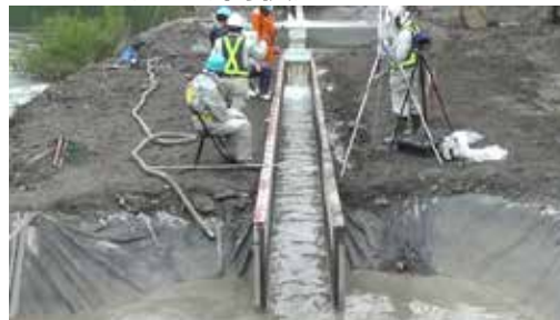
流水力による河床洗掘が進行②
