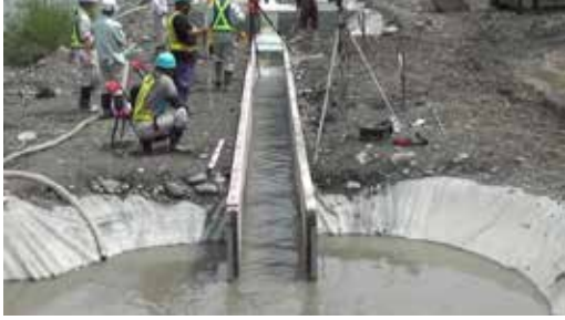
流水力による河床洗掘が進行②
