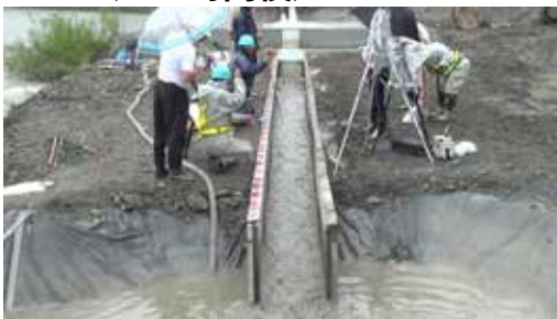
落下流の攪乱による土砂洗掘①
