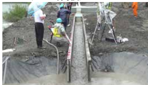
落下流の攪乱による土砂洗掘②
