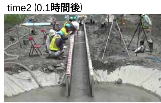
落下流の攪乱による土砂洗掘②
