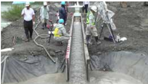
流水力による河床洗掘が進行①
