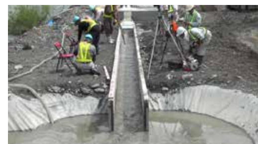
流水力による河床洗掘が進行①
