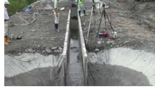
流水力による河床洗掘が進行 (通水終了)
