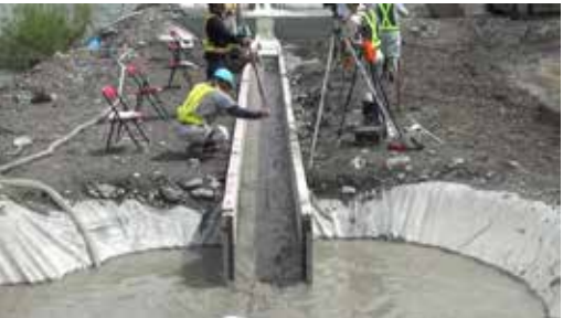
落下流の攪乱による土砂洗掘①
