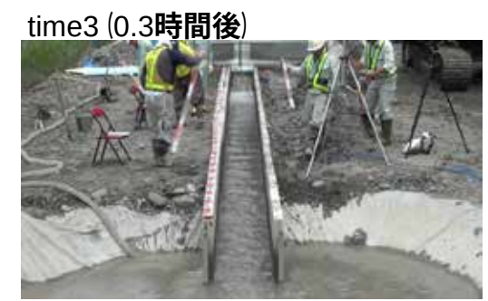
流水力による河床洗掘が進行①
