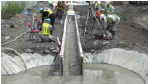
落下流の攪乱による土砂洗掘②
