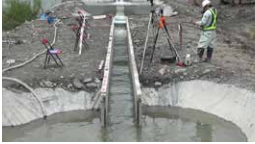
流水力による河床洗掘が進行③
