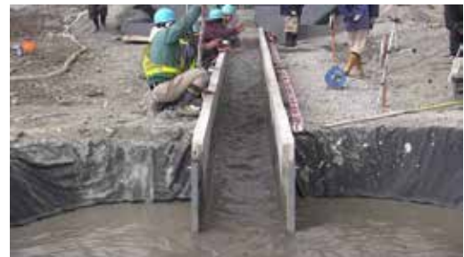
落下流の攪乱による土砂洗掘③
