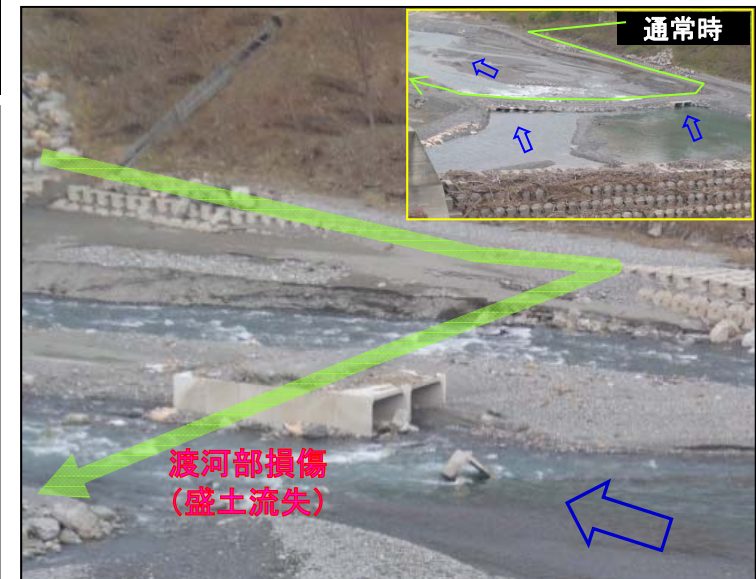
渡河進入路の流失状況
