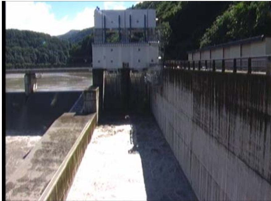
【土砂バイパストンネル呑口（主ゲート）】①
