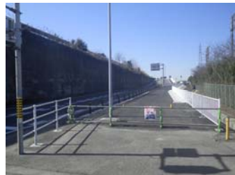
起点から藤井ICを望む 側道上り線の歩道は平成29年3月6日より利用可能です。
