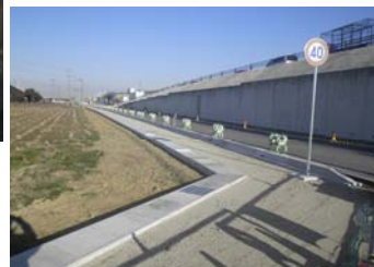
終点から藤井ICを望む 2月28日まで側道通行止めにて上り線歩道施工中です。
