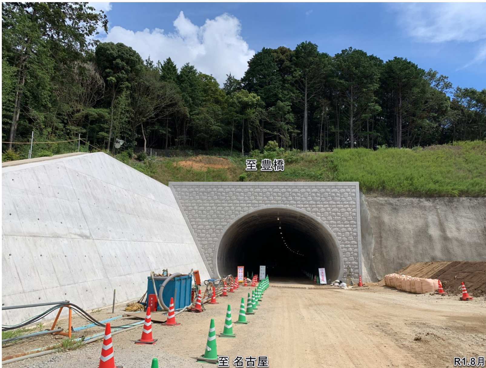
豊沢トンネルの名古屋側坑口(延長336m)施工状況(約336m掘削 9月末現在)
