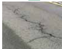
●舗装のひび割れの様子。
