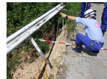
被災状況調査
