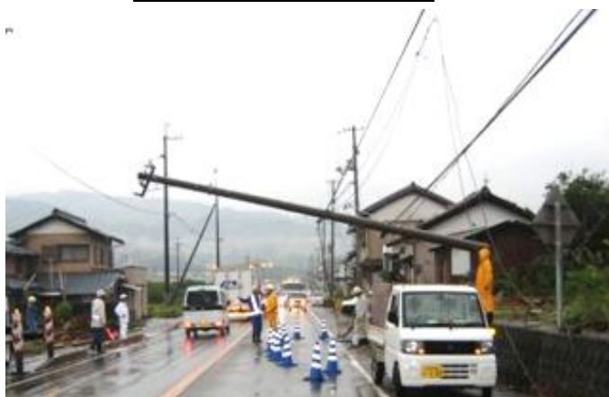
災害による電柱の倒壊(国道55号高知県安芸市) (国土交通省HPより)
