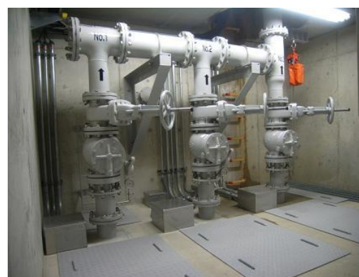
アンダーパス排水ポンプ設備
