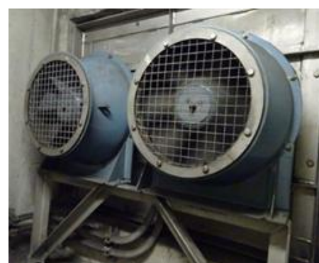
共同溝換気設備
